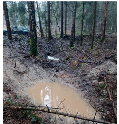
Bild 1: kleiner Tümpel am Ausgang von einem Durchlass. Kosten 50,00 € und kann 1m 3 Wasser speichern.
